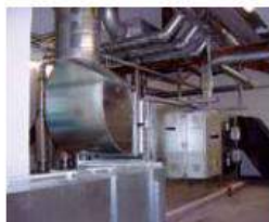
Zentrale der Zu-/Abluftanlage
